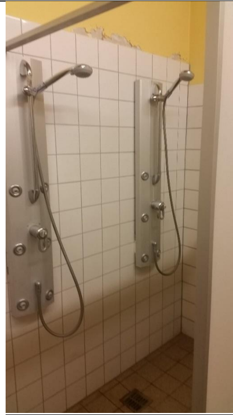
Gemeinschaftsduschen, Putzabplatzungen im kompletten Sanitärbereich
